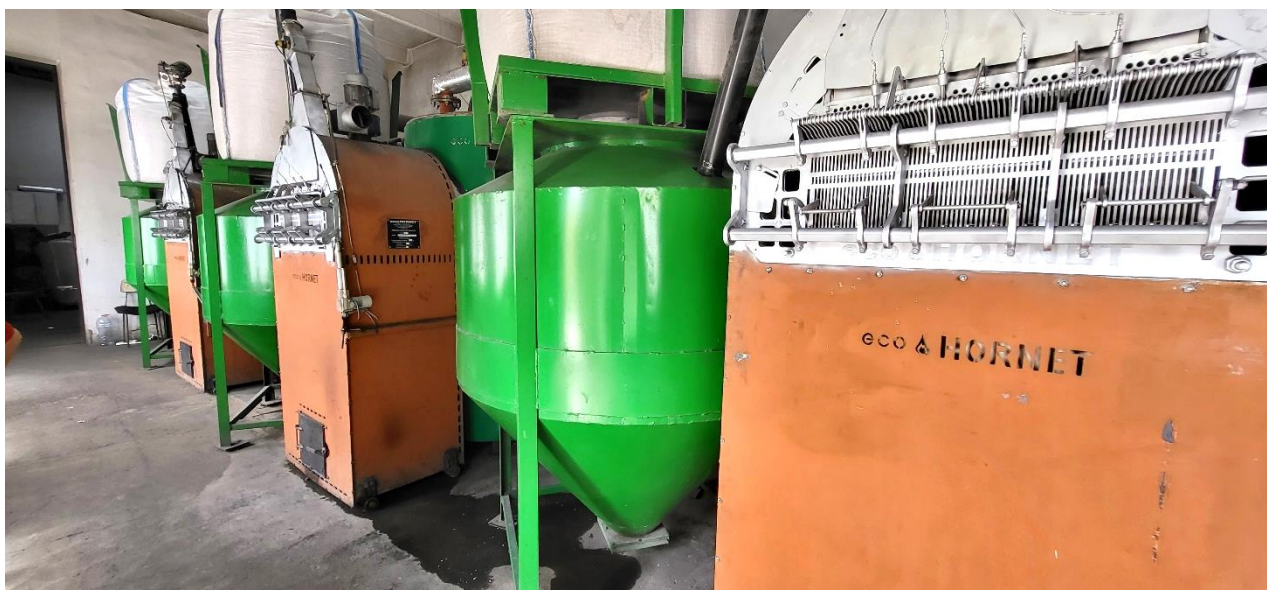
Fig. 2.7. Sub-contur 4: CT Integral, echipată cu 3 cazane ecoHORNET CT 350 (525 kW fiecare)
