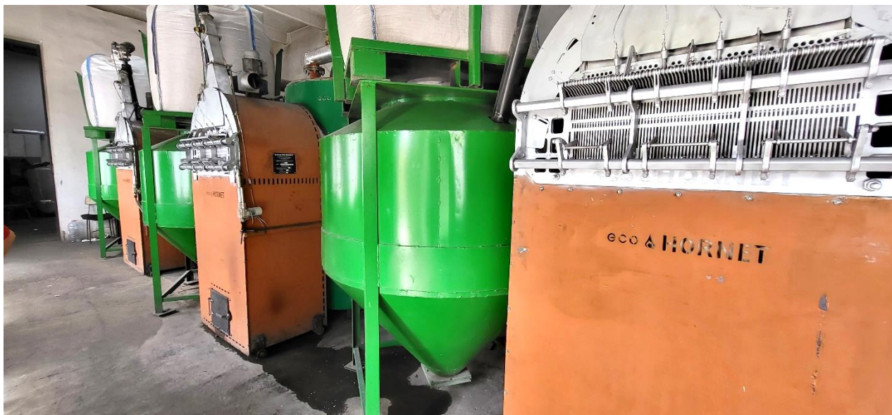
Fig. 6.12. Sub-contur 4: CT Integral, echipată cu 3 cazane ecoHORNET CTP 350 (525 kW fiecare)
