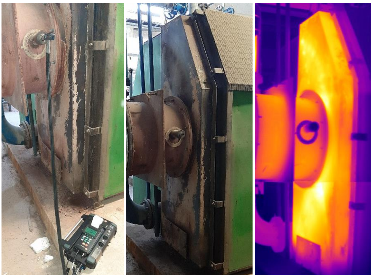
Fig. 6.e. CT4 Dorobanți: analiză gaze de ardere la cazanul HR3-3200, cu analizorul de gaze Testo 300 XXL, respectiv inspecție termografică pentru determinare pierderi de căldură prin pereții cazanului
